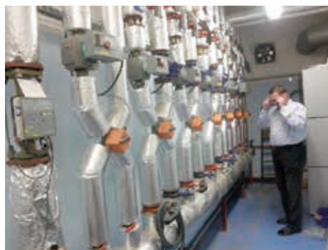
集中給湯暖房システム管理装置
